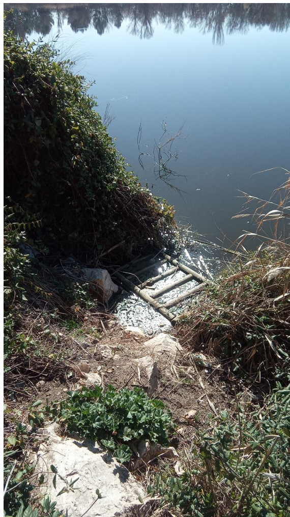
Punto de salida del colector (a la izquierda) con restos de los materiales grasos. 27-2-2019
