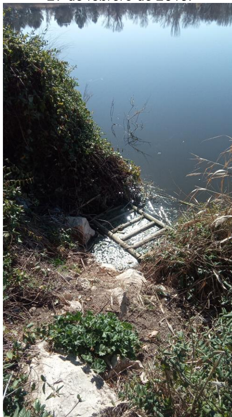
Punto de salida del colector (a la izquierda) con restos de los materiales grasos. 27-2-2019
