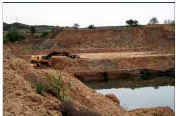
MARESA, verano de 2012. Máquina trabajando en una laguna de reciente creación. La legislación del Parque prohíbe expresamente el afloramiento de nuevas láminas de agua.
